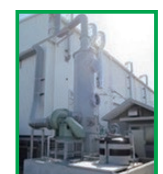
アンモニア除害設備 処理風量:3000m 3 /h
