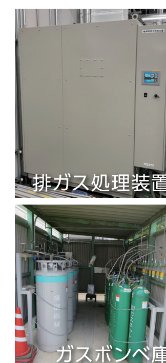
大型システムを評価するための設備
