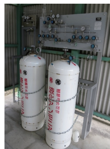
アンモニア供給設備
