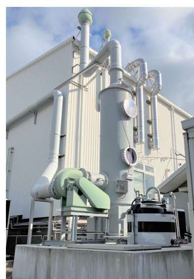
アンモニア除害設備
