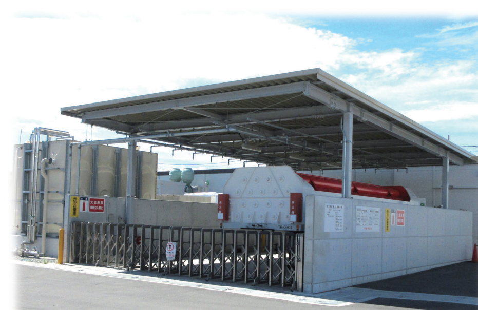
水素供給設備 貯蔵量: 5800m³
