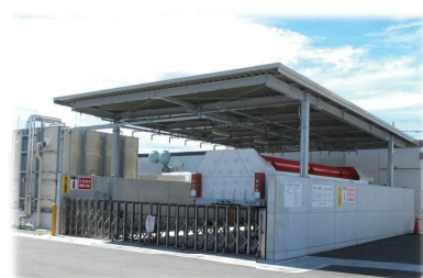
KRI水素供給設備 貯蔵量：5800 m³
