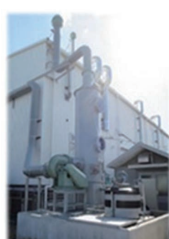
アンモニア除害設備
