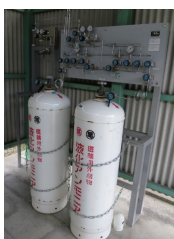
アンモニア供給設備
