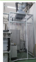
・給排気設備 アンモニアセンサ
